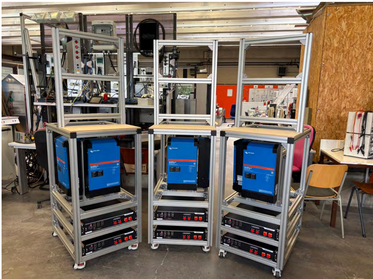
Abb. 4-1: Drei vollständig montierte 19-Zoll-Racks im fertiggestellten Zustand. Jedes Rack enthält zwei Batteriespeicher (Pylontech US2000C), drei Wechselrichter (Victron MultiPlus-II) .
